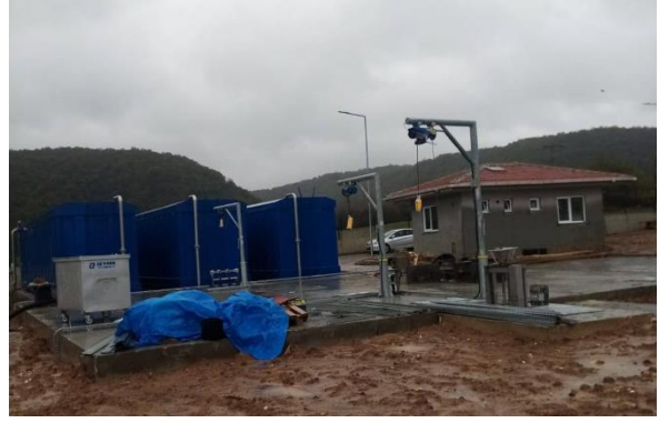
Kıyıköy paket atıksu arıtma tesisi
