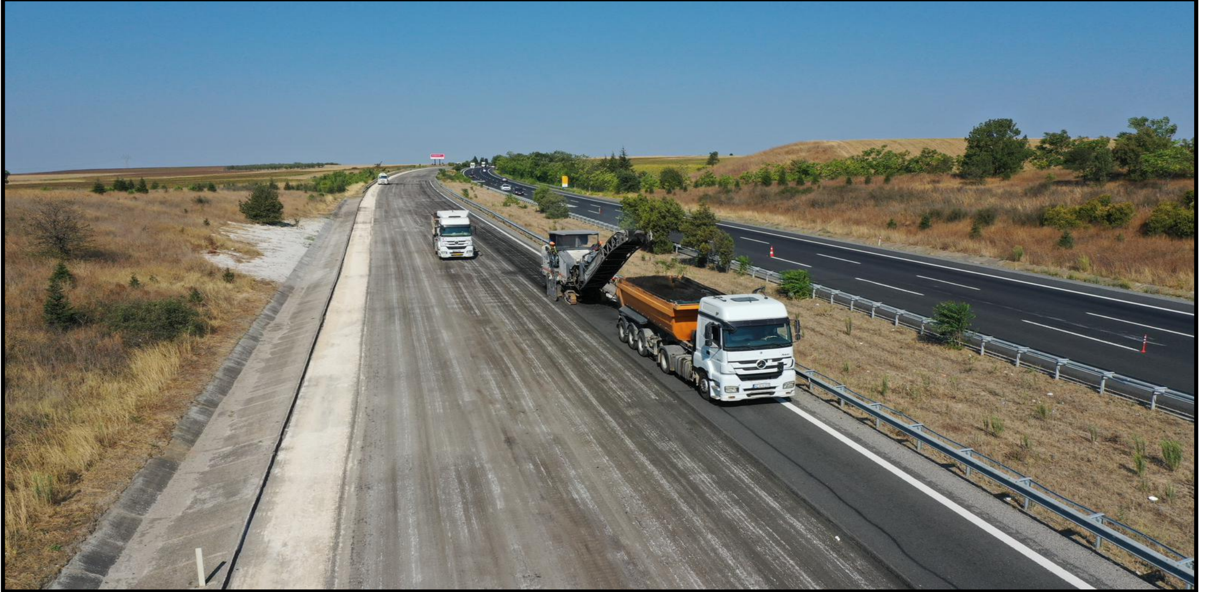
Lüleburgaz-Saray KavŖađı Arası O3/07 Km:11+000 (İstanbul Yönü)
