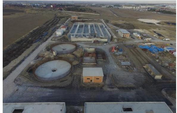
Büyükkarıştıran OSB Atıksu Arıtma Tesisi
