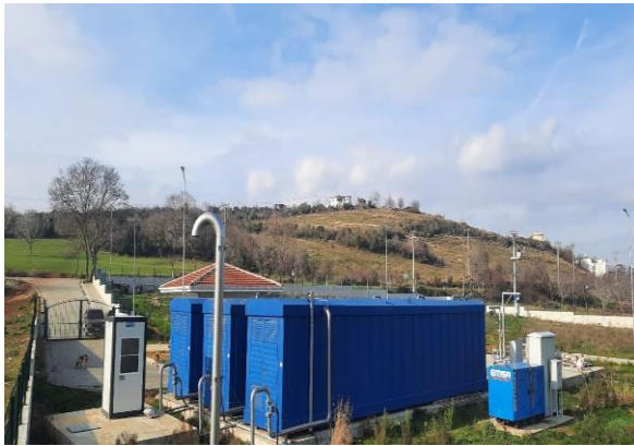
Kıyıköy paket atıksu arıtma tesisi
